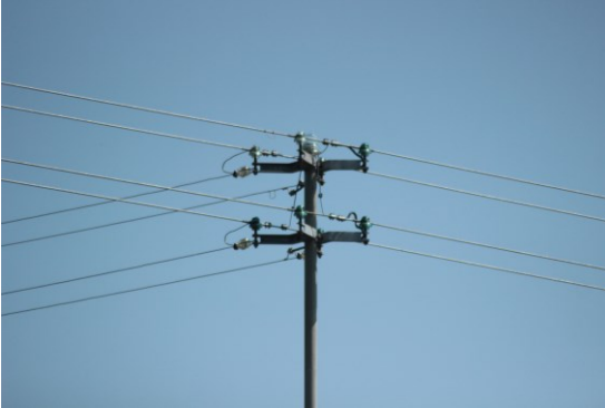
Dachständerleitung Einzelkabel: Störungen zu erwarten (von uns nachgeprüft)
