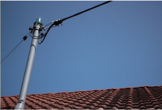
Dachständerleitung mit verdrehtem Kabel: keine Störungen bei korrekter Hausinstallation (von uns nachgeprüft)
